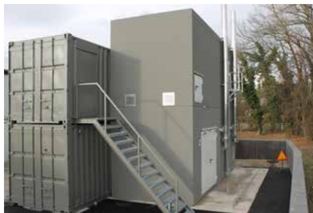
Conteneur de chauffage double 2x90kW à granulés, industrie
